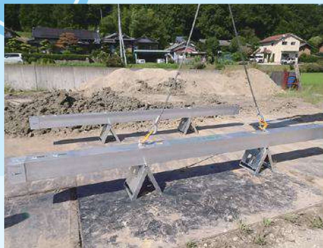
① 四面梁4・5型腹起しを、開削寸法に応じた幅で四面梁用組立スタンド等の上に置きます
