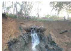
・ 水道管破損による土砂流出
