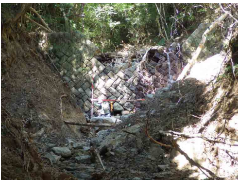
写真-1 平成30年7月豪雨により被災した石積砂防施設の例
