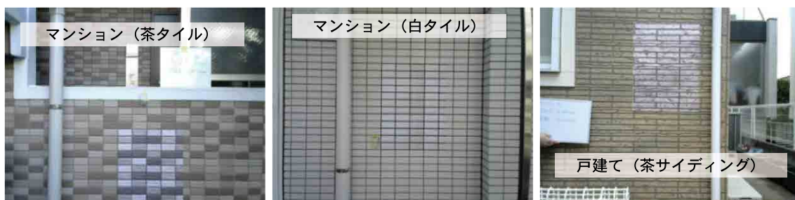
写真-5 パネル設置後の撮影画像の例（カメラ1、撮影距離2000mm、ひび割れ幅0mm）
