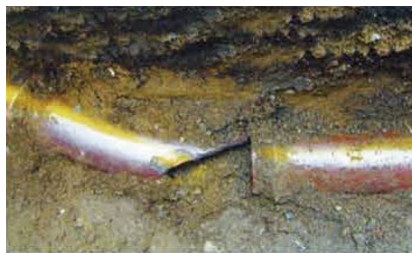
図－8 陶管の破損状況
