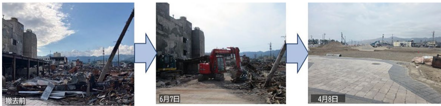
図－5 輪島朝市における解体・撤去工事（左図：撤去前、中図：令和6年6月7日、右図：令和7年4月8日時点）
