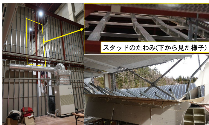
図-6 能登半島地震（2024年）におけるLGS壁の被害
